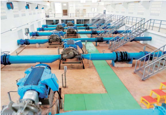
Alimentation en eau potable à Brazzaville (Congo)
